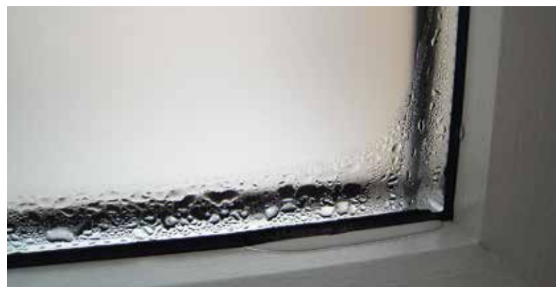
Bei minus acht Grad Celsius Außentemperatur ist die raumseitige Glaskante weiter abgekühlt. Es bildet sich viel Kondensat, was durch Schimmelbildung zum hygienischen Problem wird. Die Warme Kante hätte dies wahrscheinlich verhindert.
