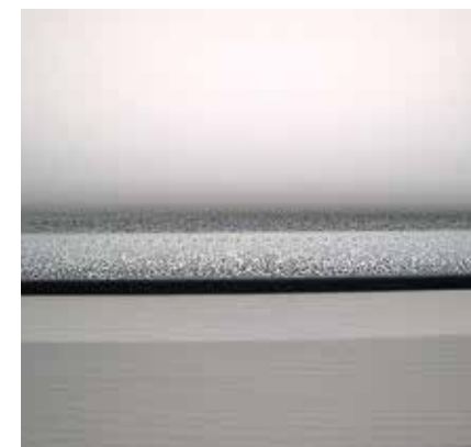
Zweifach-Iso mit Alu-Abstandhaltern zeigt je nach Raumluftfeuchte oft bei minus zwei Grad Celsius Außentemperatur geringfügigen Beschlag an der raumseitigen Glaskante.
